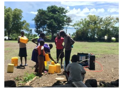
Installation d'un système d'assainissement de l'eau
